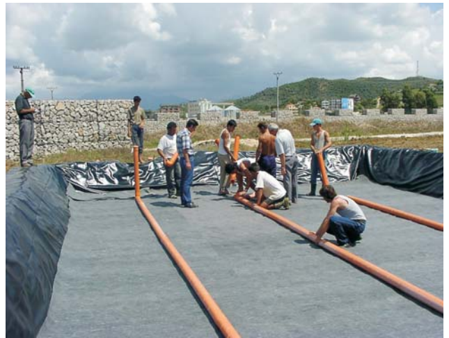
Tirana, Albania, 9 m 3 /d Planta para aguas residuales procedentes de una fábrica de la industria metalúrgica.
