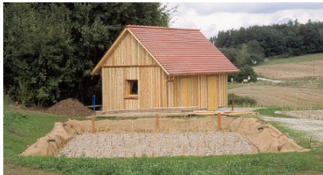
Klärschlammvererdungsanlage kurz vor Inbetriebnahme
