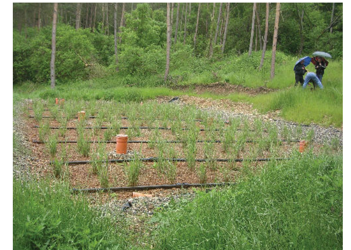
Wurmlingen, Landkreis Tuttlingen, Baujahr 2005 Für die Hausmülldeponie „Hölzle“ in Wurmlingen planen wir eine Pflanzenkläranlage. Das Ziel, eine hohe Nitrifikation, wird seit Inbetriebnahme durchgehend erreicht
