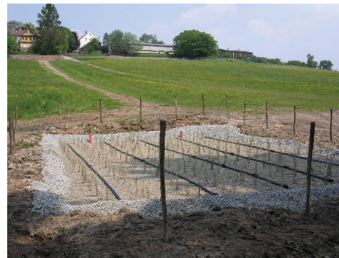
Welzheim - Rems-Murr-Kreis, Baujahr 2004 Vertikalfilter kurz nach Fertigstellung. Die Anlage kann direkt nach Inbetriebnahme mit voller Last beschickt werden.
