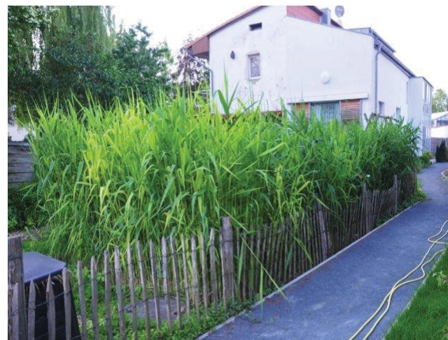
Frankfurt-Sachsenhausen - Baujahr 2002 Pflanzenkläranlage auf engstem Raum: Kurze Leitungswege, und keinerlei Beeinträchtigung der Wohnqualität.
