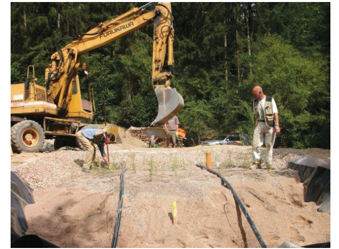
Korlingen, VG Waldrach - Baujahr 2010 Die kleinste Einheit beträgt 16 m 2 Filterfläche. Es sind 1-4 Einwohnergleichwerte angeschlossen.
