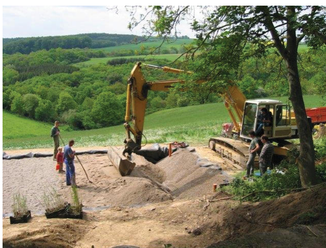
Dalheim, VG Loreley, Baujahr 2005 Sorgsam aufeinander abgestimmte Sand- und Kieskörnungen sorgen für eine lange Lebensdauer unserer Pflanzenkläranlagen.
