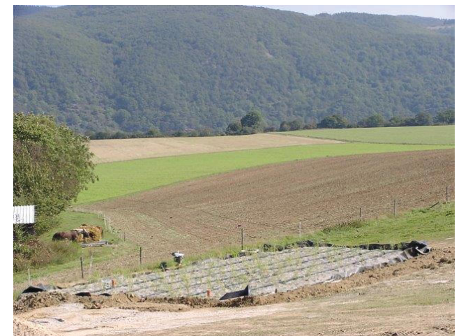
Bacharach, VG Bacharach - Baujahr 2005 Ein verzweigtes Beschickungssystem aus PE-Rohren sorgt für eine gleichmäßige Verteilung des Abwassers auf der Filteroberfläche. Der Filter wird optimal ausgenutzt.
