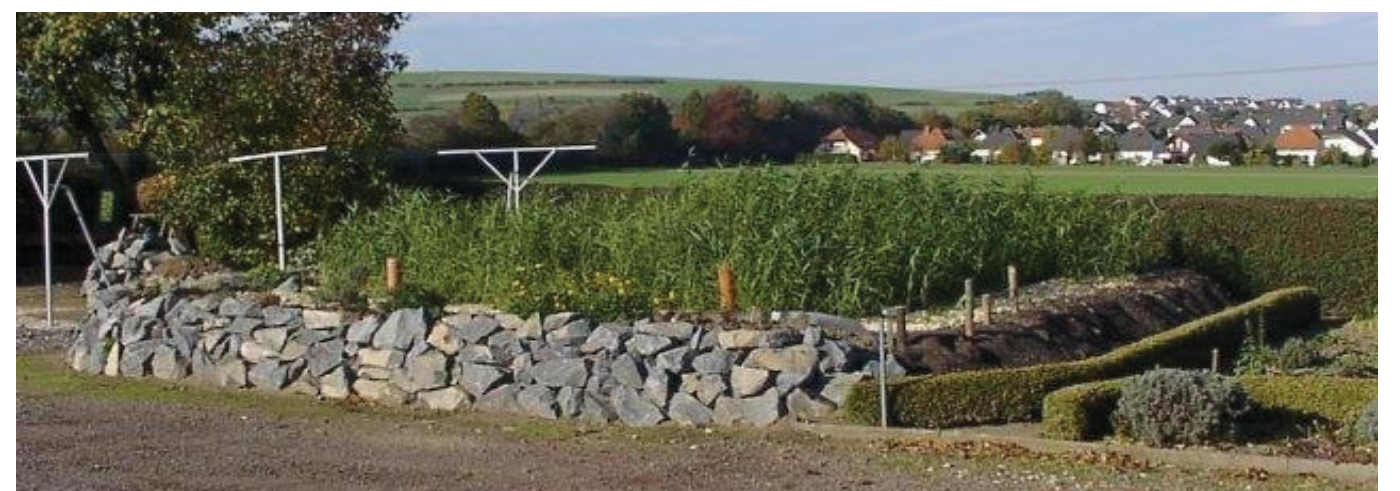
Polch, VG Maifeld - Baujahr 2005 Ab einem Abstand von ca. 300 m zur innerörtlichen Bebauung lohnt sich bereits eine eigene Pflanzenkläranlage. Die Gestaltung der Böschung obliegt dabei dem individuellen Geschmack der Bauherrschaft.
