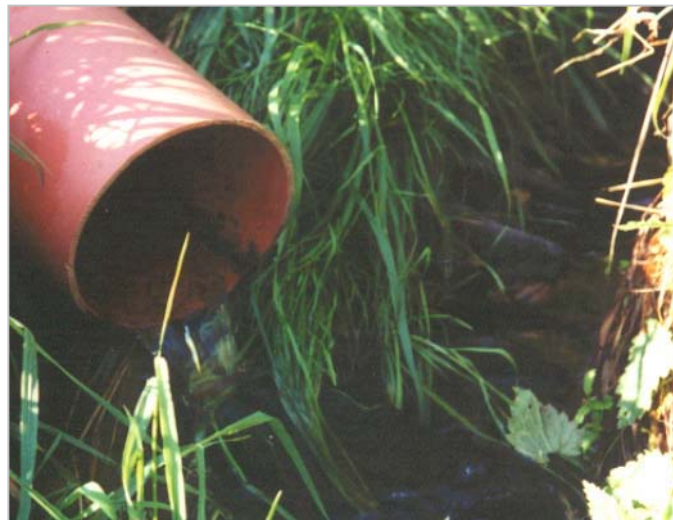
Oczyszczone ścieki splywają kłarowne do odbiornika eków
