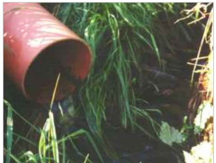
Das gereinigte Abwasser fließt glasklar in den Vorfluter
